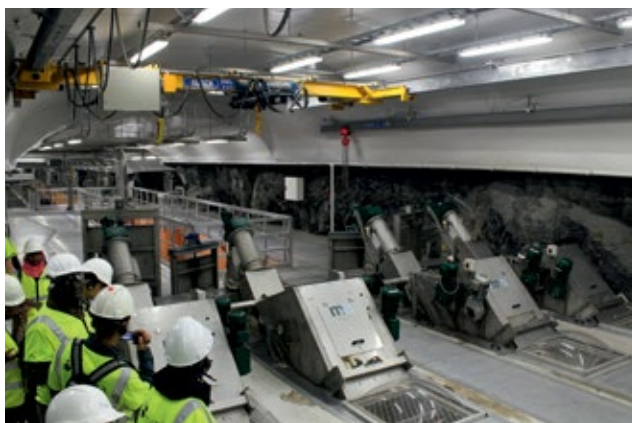
Ознакомительная практика студентов на коммунальных очистных сооружениях бытовых сточных вод г. Осло, Норвегия
